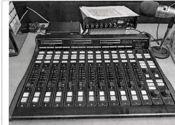
Se pone en operación la consola, y se entradas y salidas de audio, audio de program, audio en canales auxiliares quedando funcionando correctamente.
